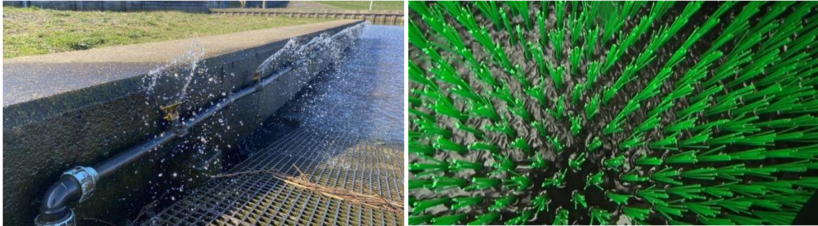
Figuur 3.2 Aalgoot bij spuisluis Nieuwe Statenzijl
