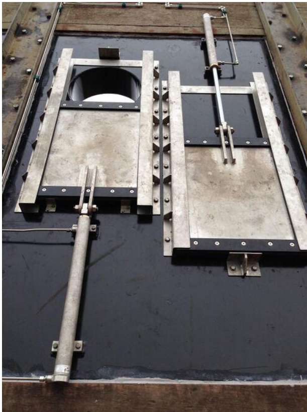
Figuur 3.7 Kattenluik in een spuideur voor het inlaten van vis bij opkomend water (Waterschap Hunze en Aa's). Een oplossing die typisch is voor zoet-zout overgangen en daar goed functioneert (als er voldoende water ook weer naar binnen mag stromen)
