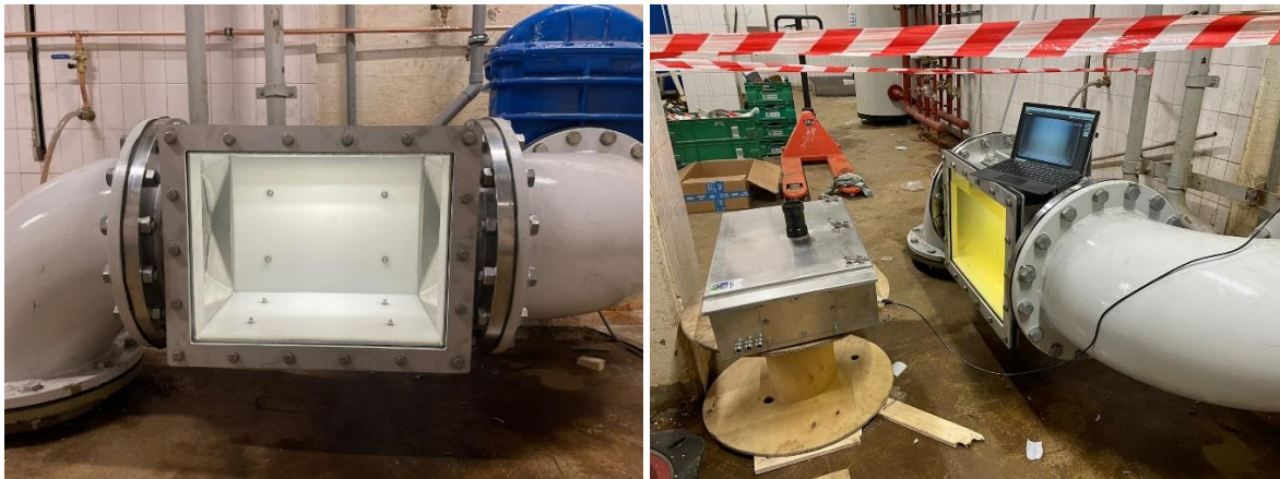
Figuur 4.1 Voorbeeld van een camera opstelling in een leiding van een vissluis (gemaal Vissenring, Urk).
